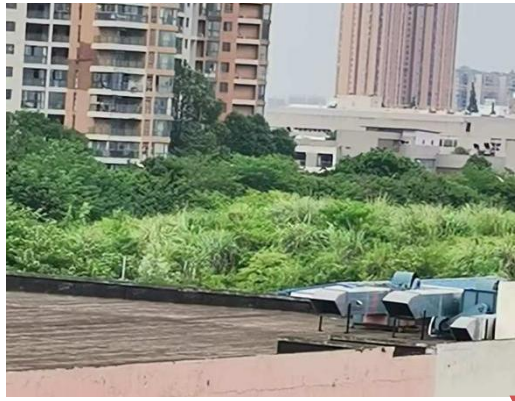
食堂油烟排气筒
